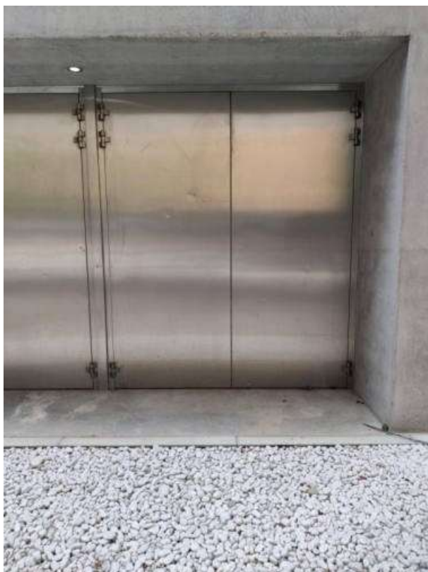
Uscite di sicurezza: stato dei luoghi
